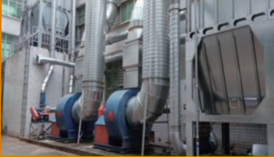
木工車間粉塵處理裝置
