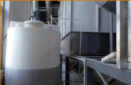
板式傢具廠廢水處理裝置
